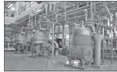
i) Red de tuberías en una planta industrial
