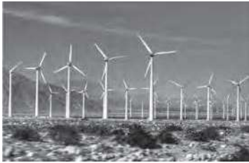
g) Turbinas eólicas
