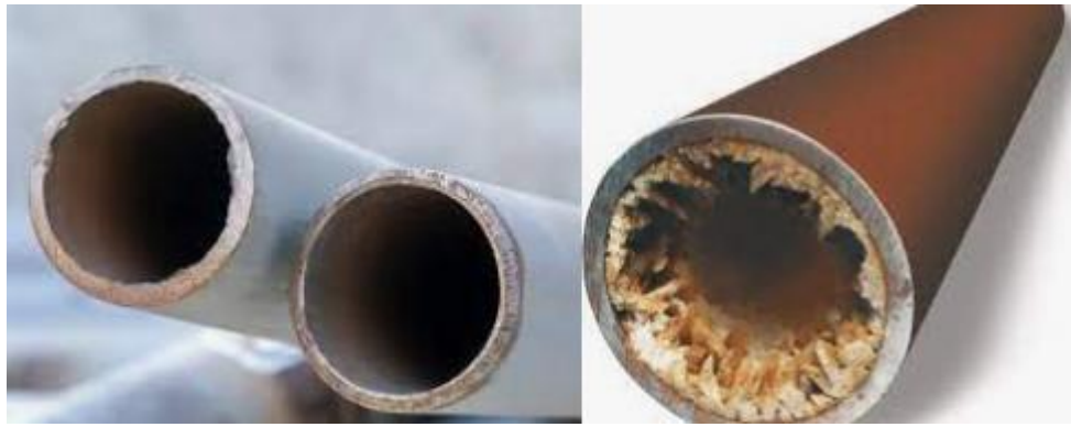
Figura 6.2. Tubería nueva y usada (incrustaciones)
