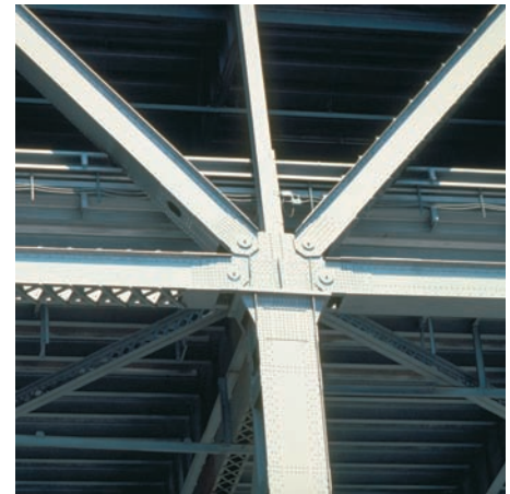
Fotografía 6.1 En la foto se muestra una conexión con juntas de pasador sobre el acceso al puente de la Bahía de San Francisco y Oakland.
