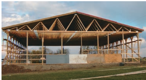
Fotografía 6.3 Las armaduras para techo, como las que se muestran en la foto, requieren apoyo sólo en los extremos. Gracias a esto es posible realizar construcciones con grandes áreas libres de obstáculos en el piso.
